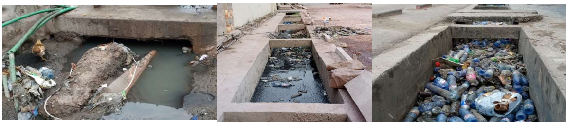
Figure 4. Détritus dans la rigole sur la chaussée et Eaux stagnante dans la rigole
