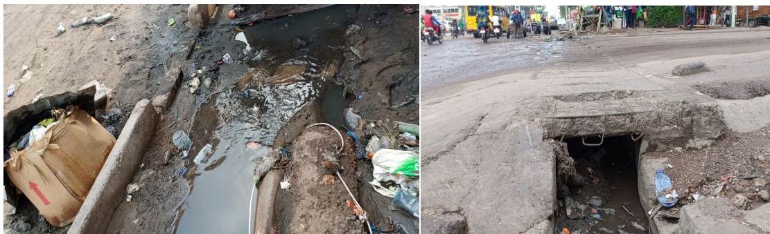
Figure 3. Illustration de l'état des caniveaux dans le quartier d'étude
